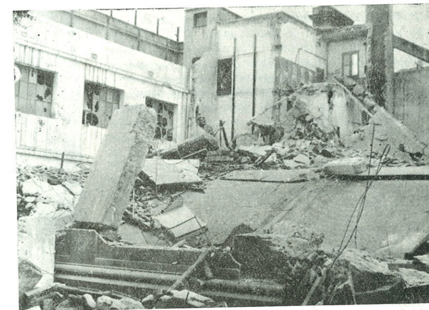
Vista parcial del edificio hundido.
